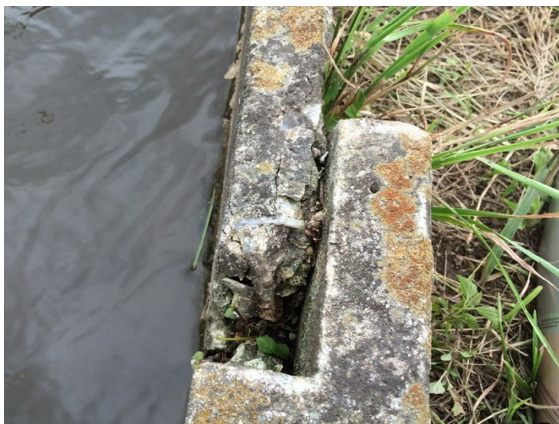
写真. 凍結融解の作用を受けた接合部
