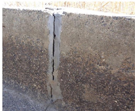
写真. シーリング材が劣化した接合部
