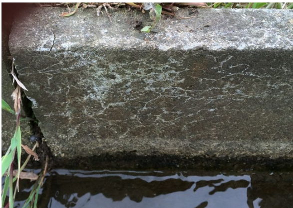
写真. 凍結融解の作用を受けたコンクリート製水路
