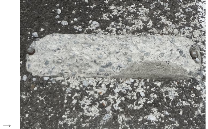
写真. 凍結融解により崩壊したコンクリートの例(車止め)
